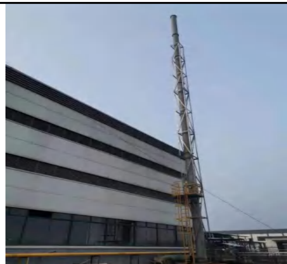
焚烧炉排气筒
