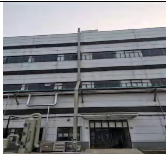
原料厂房排气筒
