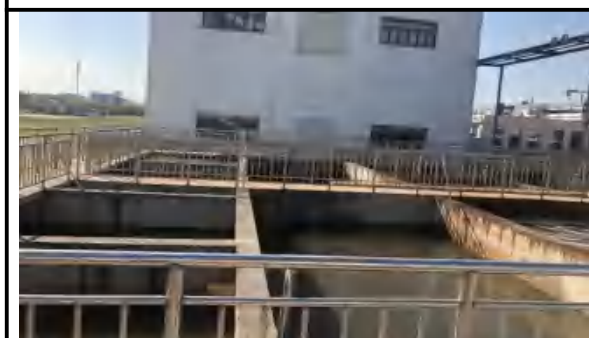
污水处理设施
