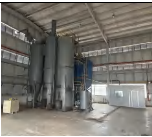
焚烧炉自动在线监测设备房
