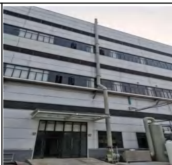
中间体厂房排气筒
